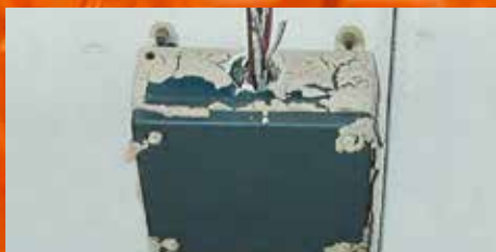
Kabelabzweigkasten mit angeschlossenen Kabeln nach dem Test
